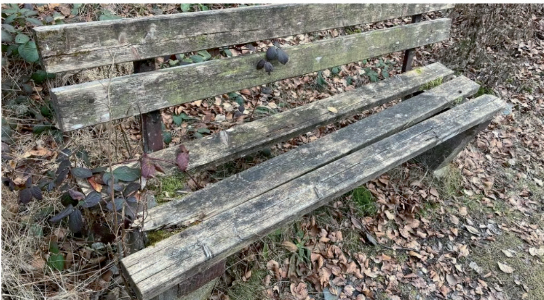
Eine der kaputten Bänke bei Stolberg, die dringend mit neuen Brettern „aufgemöbelt“ werden sollen. (Foto: Jecho)
